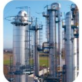
Imagen 3. Torre de fraccionamiento
